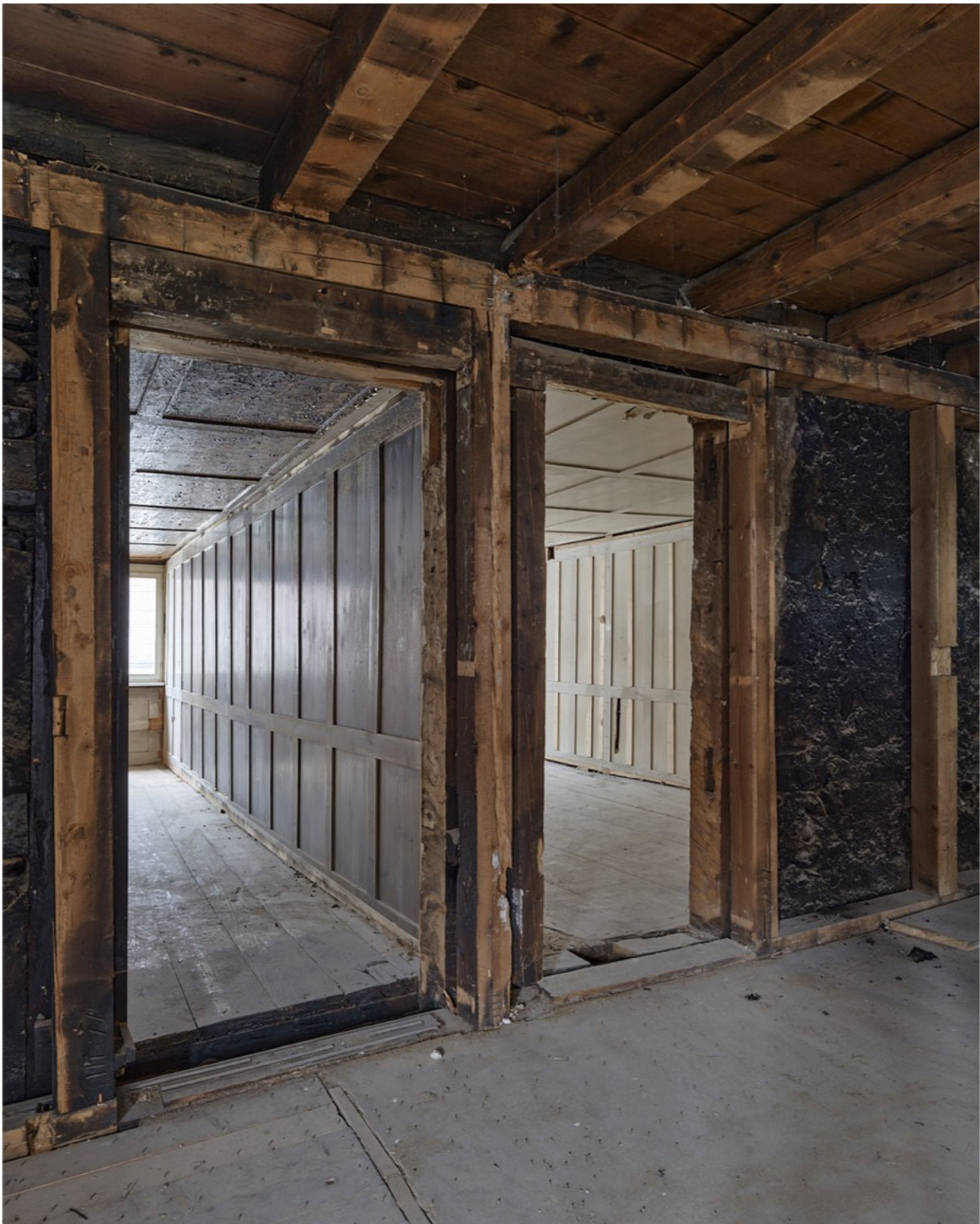
Blick in die Kammern des südlichen Hauses, mit gegen hundert Jahre alten Brandspuren.
